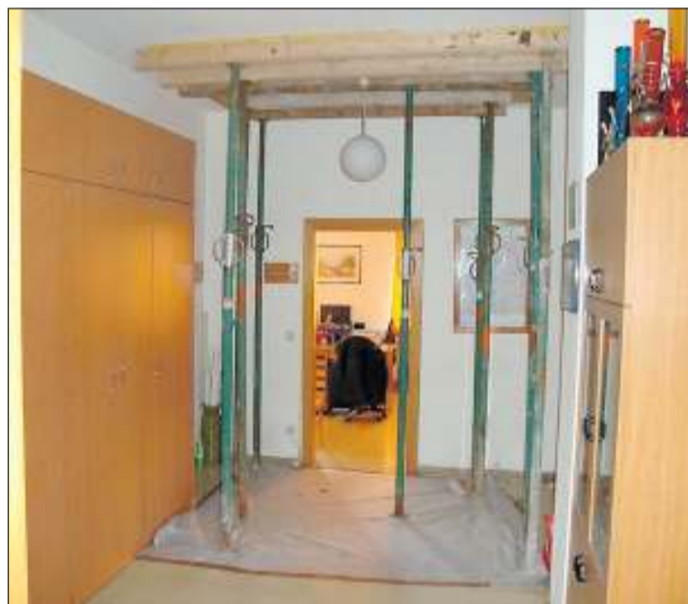
Im jetzigen Posten hatte 2010 kurz Einsturzgefahr geherrscht.
